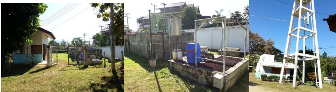
รูปภาพแสดง ระบบบำบัดน้ำเสีย และระบบประปา (โรงประปา และหอถังสูง)
